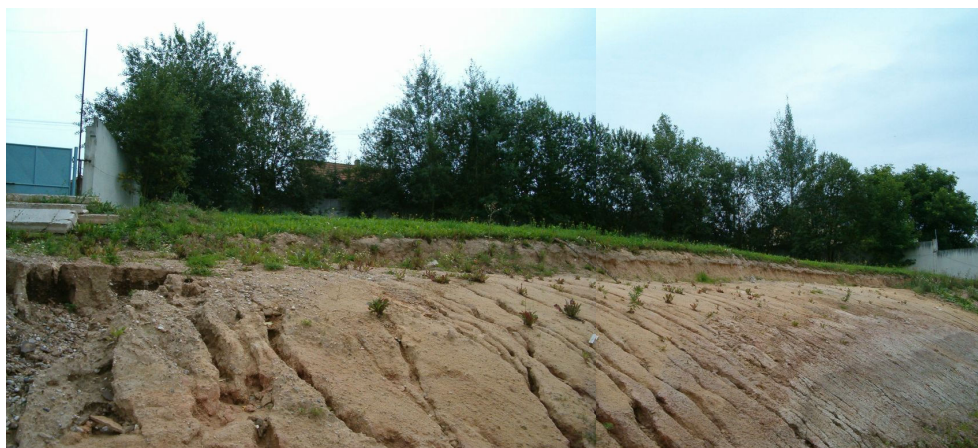
Jižní část zájmové plochy výstavby přístavby skladové haly jižně od ČOV pivovaru – v popředí erodovaná pata svahu, v pozadí oplocení areálu pivovaru a brána nouzového vjezdu
