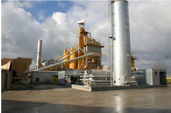
Celkový pohled na technologii AMMANN
