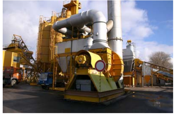
Ventilátor odtahu do komína
