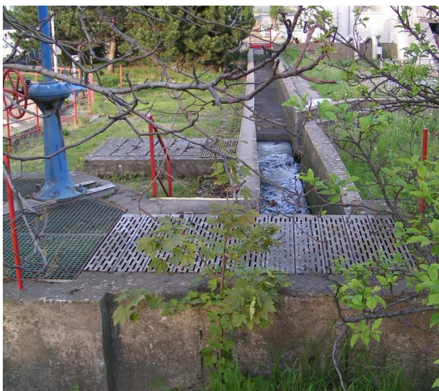
Pohled na odtok vyčištěné vypouštěné vody z ČOV, vlevo šoupě na přítoku vody, přitékající voda je provedena uzavřeným profilem DN 1000 pod otevřeným profilem vypouštěné vody.
