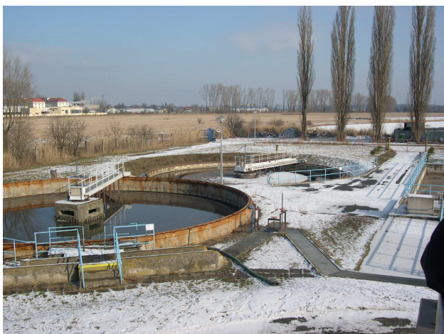
Vpředu kruhová usazovací, vzadu kruhová dosazovací nádrž, vpravo navazující nádrže de/nitrifikace
