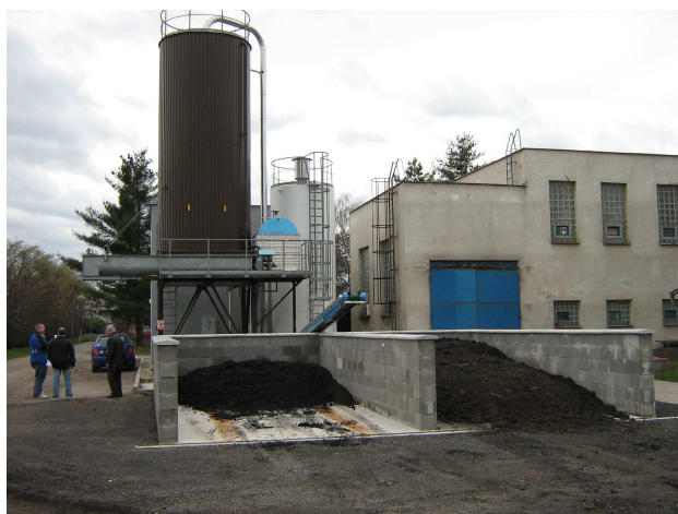
Vlevo černé vysoké kalové silo, s ním sousedící bílé silo na uskladnění vápna. Vpředu nově vybudovaná kalová pole.
