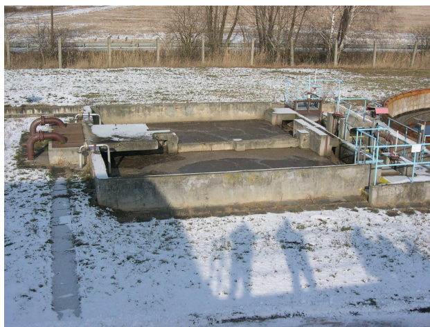
Reaerace kalu, vpravo navazující usazovací nádrž
