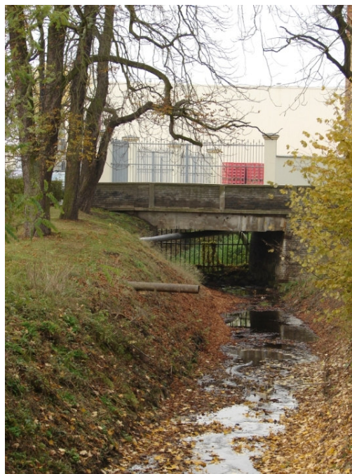
V profilu vtoku Krušovického potoka do areálu pivovaru jsou osazeny hrubé česle bránící vniknutí hrubých nečistot.
