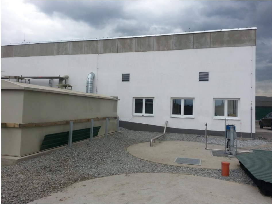
Stávající objekt příjmu bioodpadů s biofiltrem
