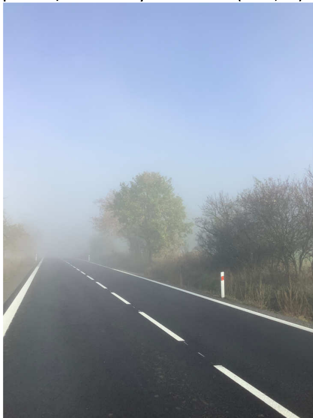
Obrázek 46 Pohled na stávající silnici II/263 severně od Velké Bukoviny, lokalita navrženého mostního objektu na přeložce I/13 a křižovatky Velká Bukovina (km 13,700)
