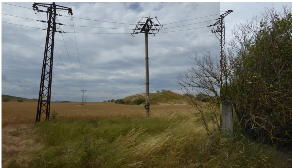
Stávají elektrické vedení na okraji těžebního prostoru
