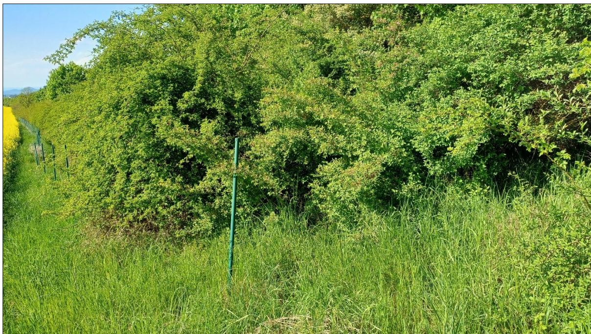
Obr. 6: Poničené dálniční oplocení, místa pronikání živočichů, zejména srnce obecného do porostů dřevin
