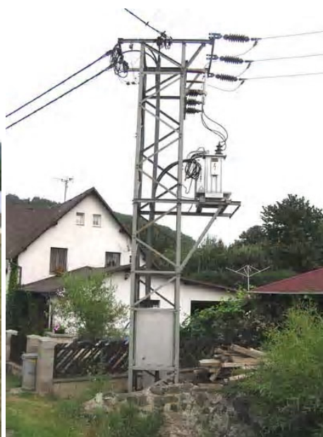
Stávající trafostanice v obci Lesná
