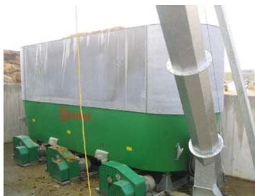
Ukázka skutečného provedení příjmového a dávkovacího zařízení – BPS Utznaich, Rakousko (500 kW e )
