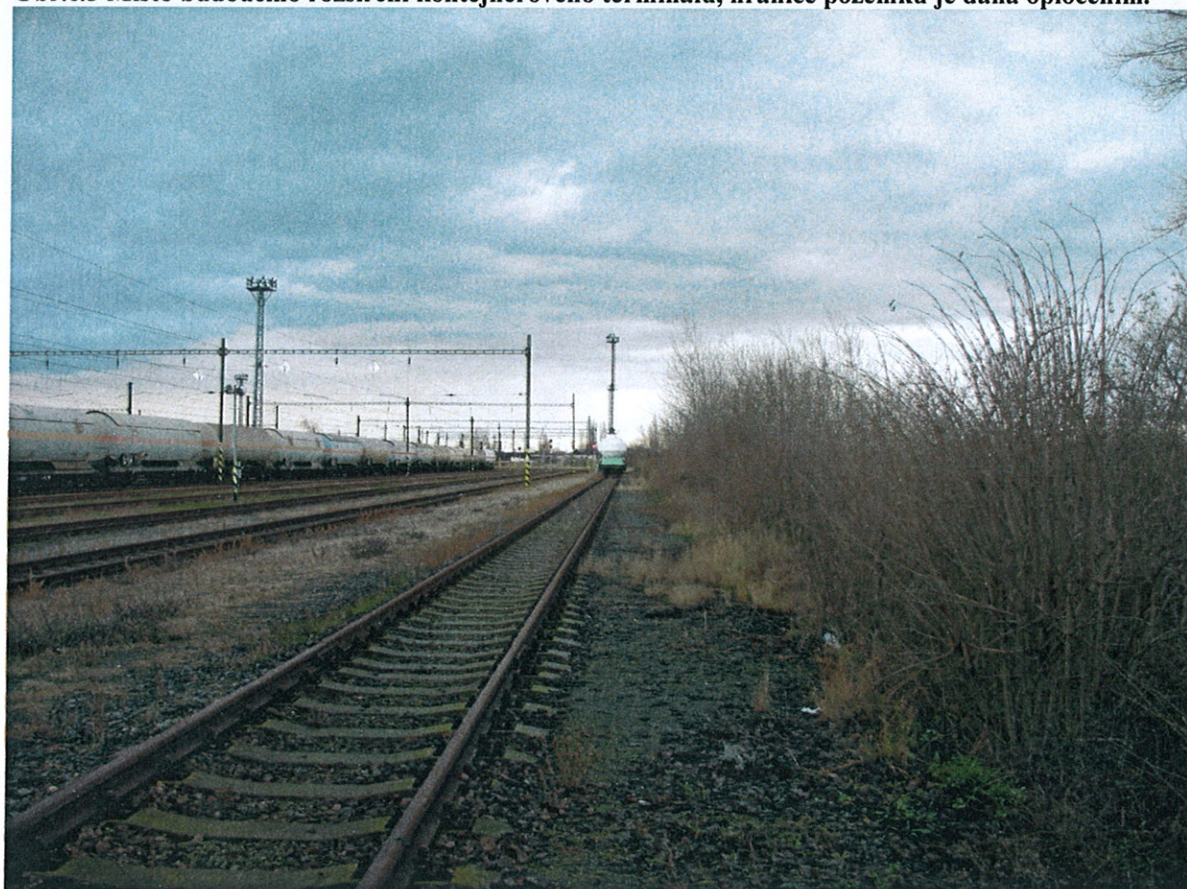
Obr.č.4 Náletová vegetace na železničním náspu.
