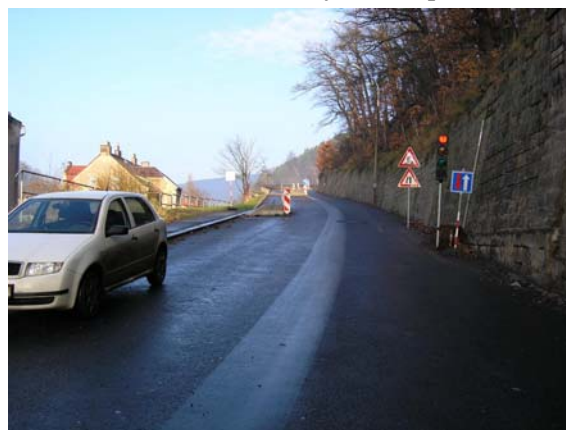
Obr. 6 Pohled na příjezd do poškozeného úseku zdola od ul. Teplická
