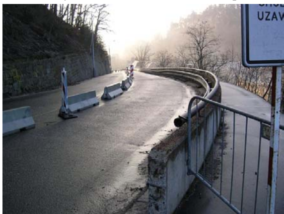
Obr. 5 Poškozený úsek stávající komunikace
