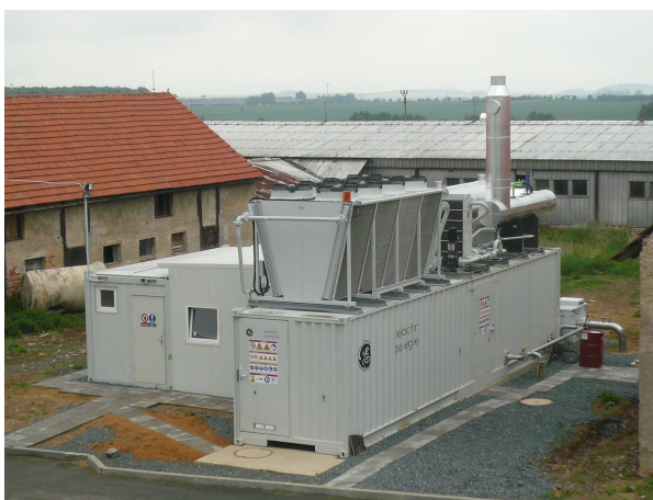
Pohled na kogenerační jednotku v kontej- nerovém provedení
