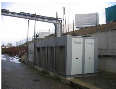
Obr. 14 Venkovní kompresorová jednotka
