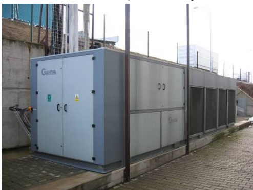
Obr. 13 Venkovní kompresorová jednotka
