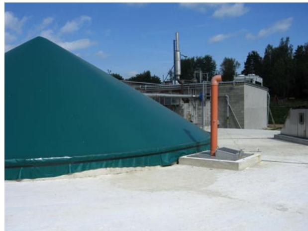
Obr.87: Detailní pohled na zakrytý fermentor, v pozadí kogenerační stanice
